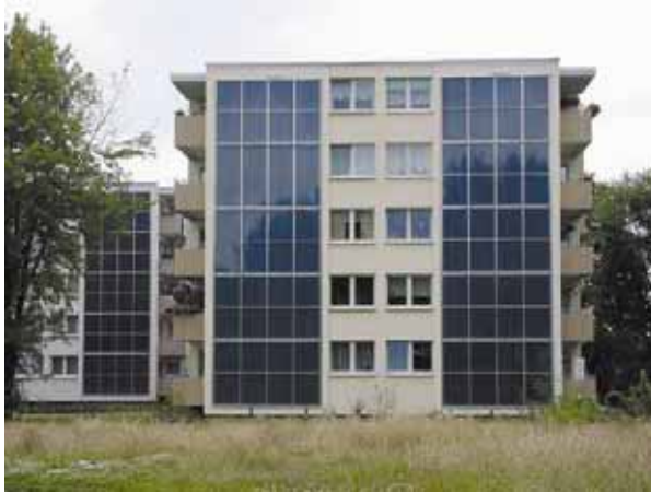
Figura 5.10 - Instalação em fachada de uma grande superfície de colectores em Bielefeld
