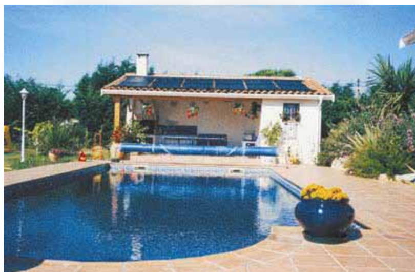
Figura 7.2 - Sistema solar com absorsores para uma piscina privada
