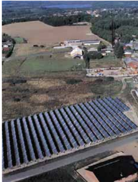
Figura 6.18 - Este sistema com uma área de superfície do colector de 3,000 m 2 , em Ry, na Dinamarca, fornece os imóveis ao fundo através de uma rede de aquecimento municipal
