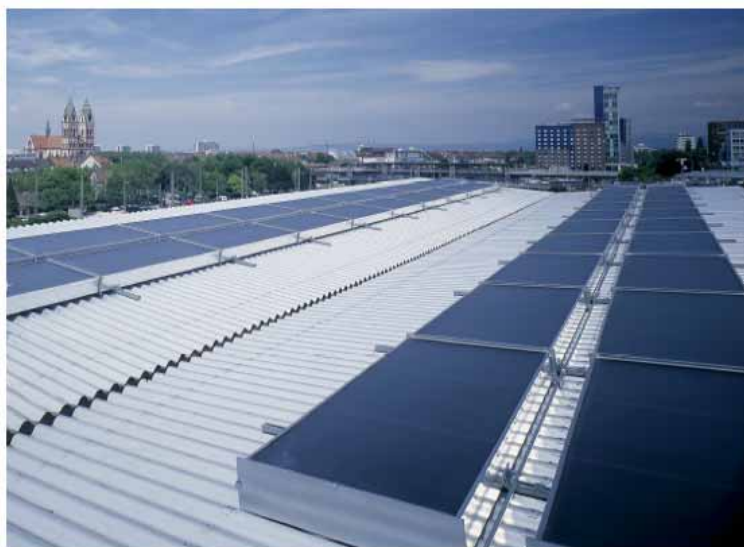
Figura 9.1 - Sistema de ar condicionado equipado com 100 m2 de colectores solares, Freiburg, Alemanha
