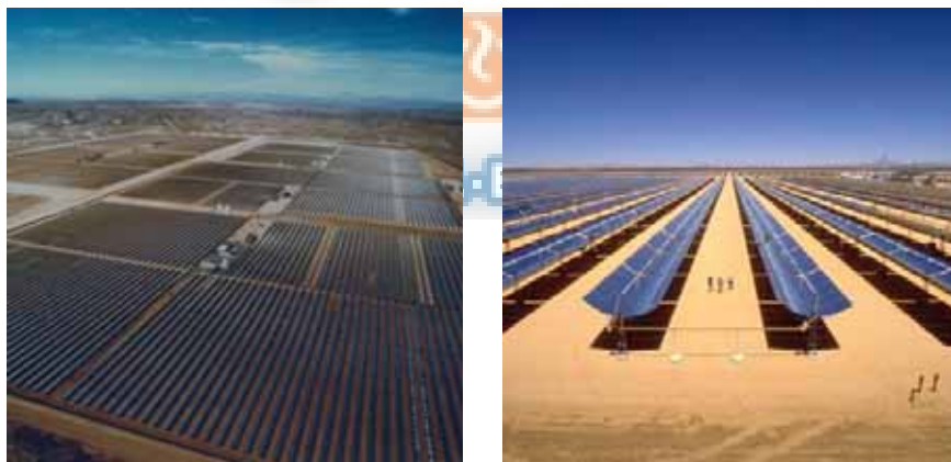
Figura 6.24 - Central com Concentradores “Trough” na Califórnia
